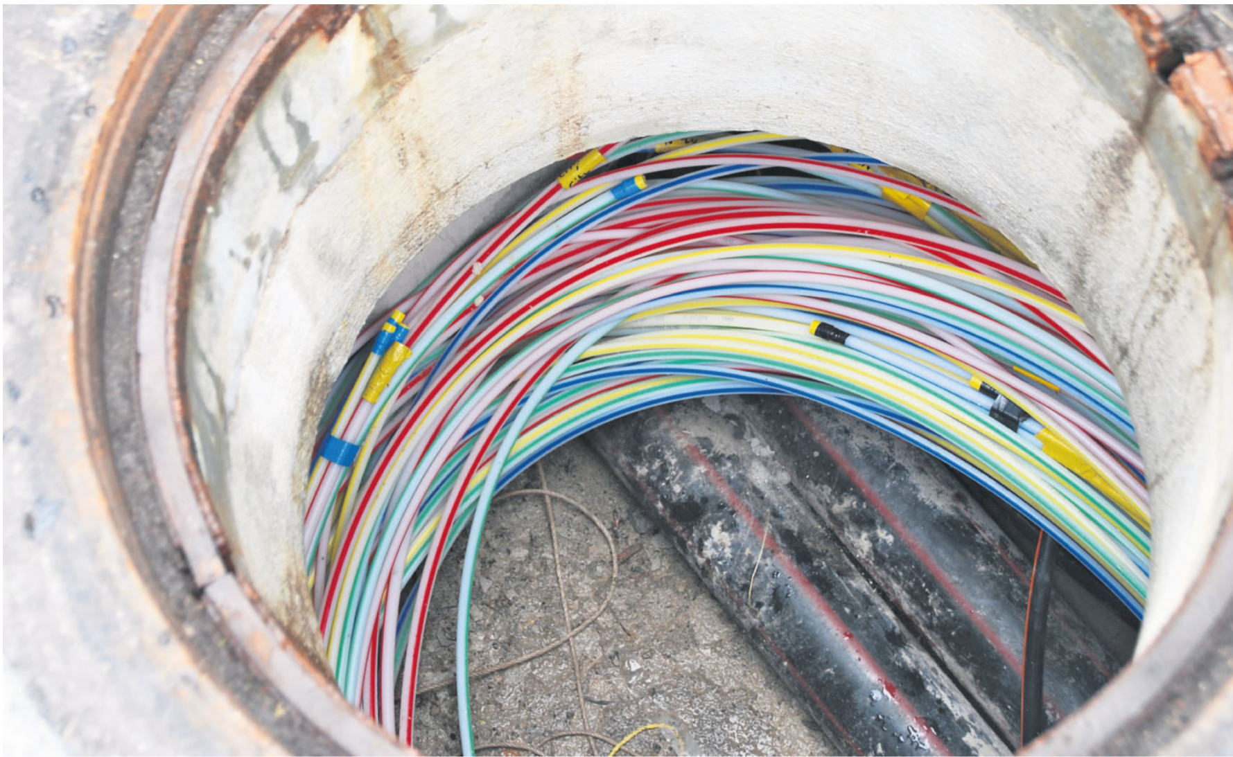
Schneller Datentransfer. Glasfaserkabel in einem Schacht in Gampel.
