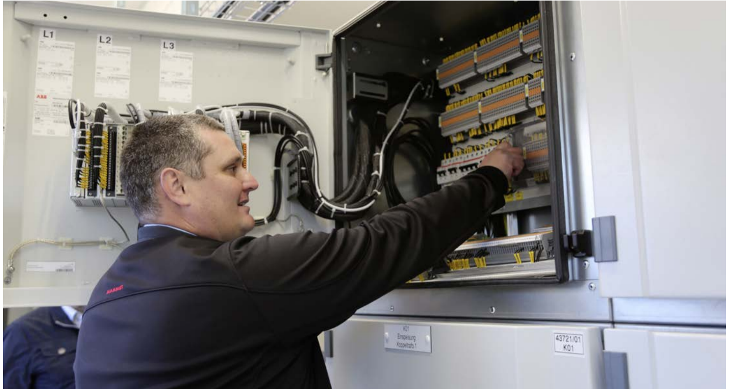
Eröffnung. Manuel Schnyder, ReLL-Betriebsleiter Netz erklärte am Donnerstag wie das neue Unterwerk Turtmann funktioniert. FOTO WB
